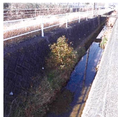
河川内の支障木
