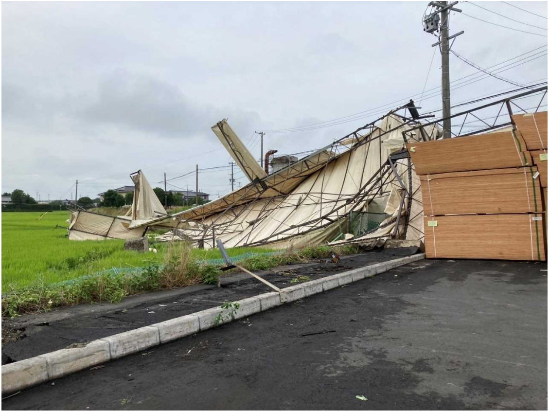
8 テント倉庫飛散、倒壊
