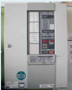
自動火災報知せつび (受信機)
