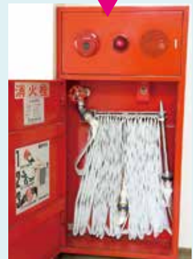
消火栓 (発信機)
