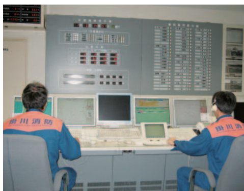
消防署通信司令室
