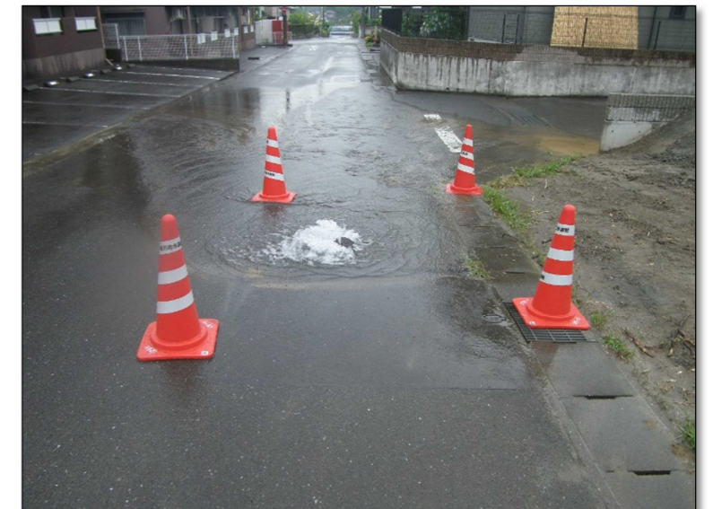
水道管の漏水状況
