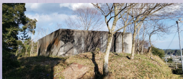
改修工事が中断となっているファームポンド貯水タンク (P7-③ 和田岡原地内における登記の誤処理)
