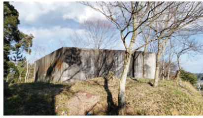
和岡原地内ファームポンド貯水タンク
