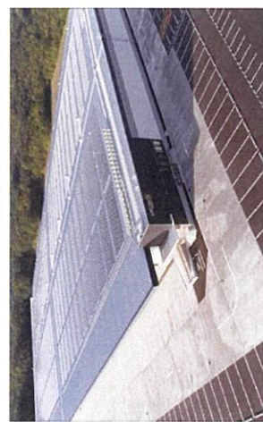
屋上太陽光発電 (当社実績：兵庫県)
