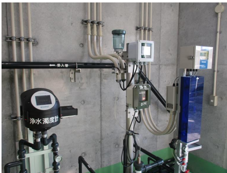
原谷浄水場水質計器
