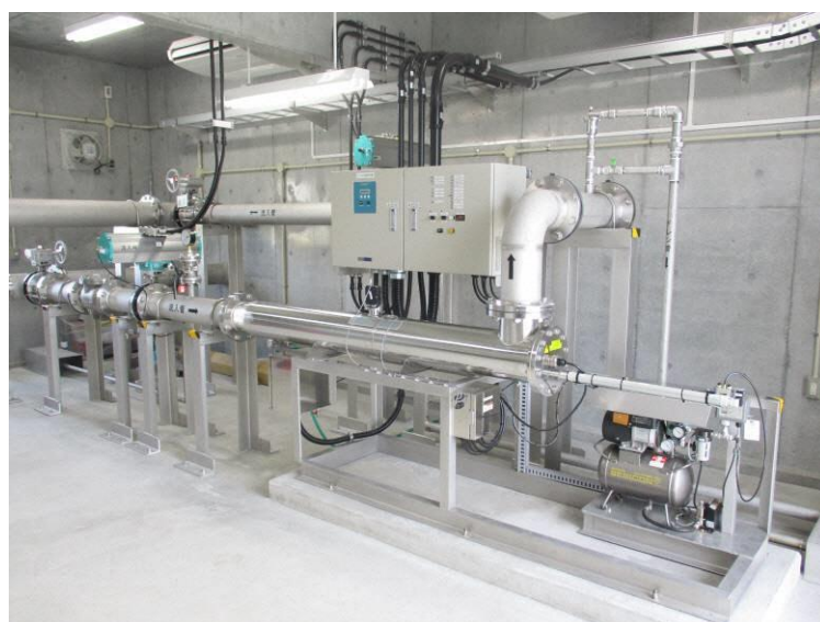
原谷浄水場紫外線照射装置
