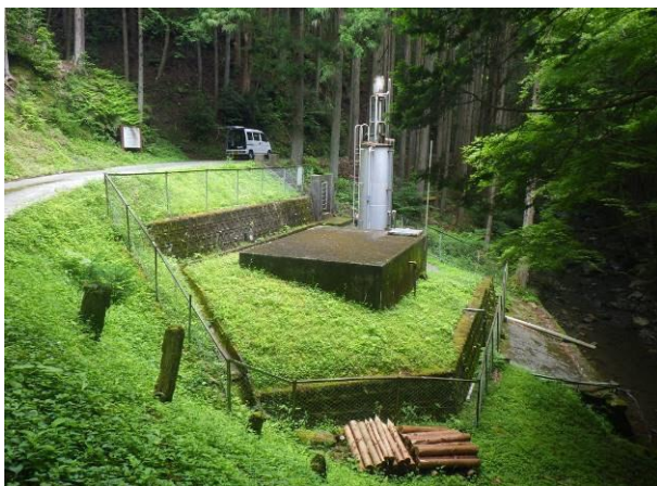
泉簡易水道浄水場
