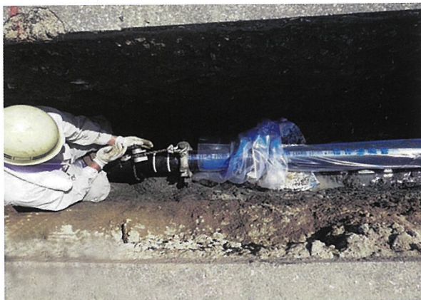
災害に強い耐震管路の布設状況 富山県南砺市上下水道課 提供
