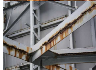
↑内部鉄骨のサビ・腐食。
