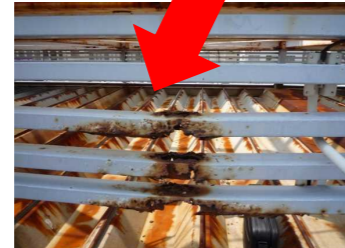
↑目隠しルーバーのサビ・腐食。
