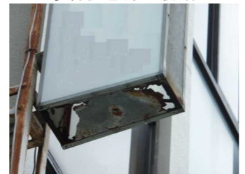
↑看板底部の留め具が壊れるとアクリル板が抜け落ちる原因にも。
