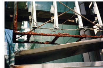
↑看板底部の脱落
