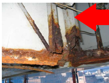
↑板面裏側のサビ、腐食。サビによる腐食はミルフィーユ状に剥がれ崩落する恐れも。
