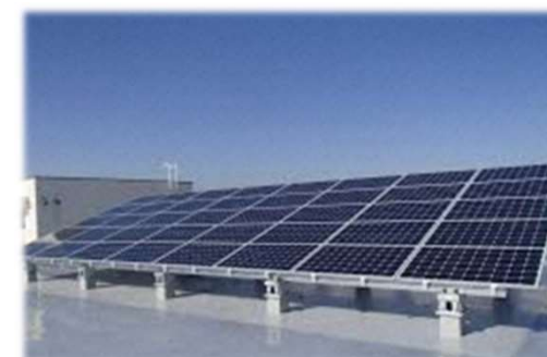
公共施設への太陽光発電の設置
