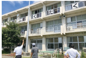
外壁が剥離する西山口小学校
