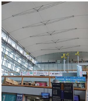
市役所本庁舎の吊り天井
