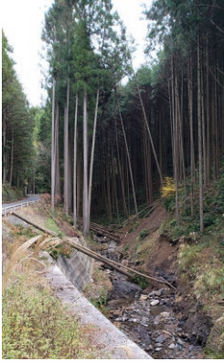
河床低下による崩落
