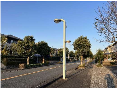
7 市道秋葉中央通り線 歩道灯 N=11 基 22 灯
