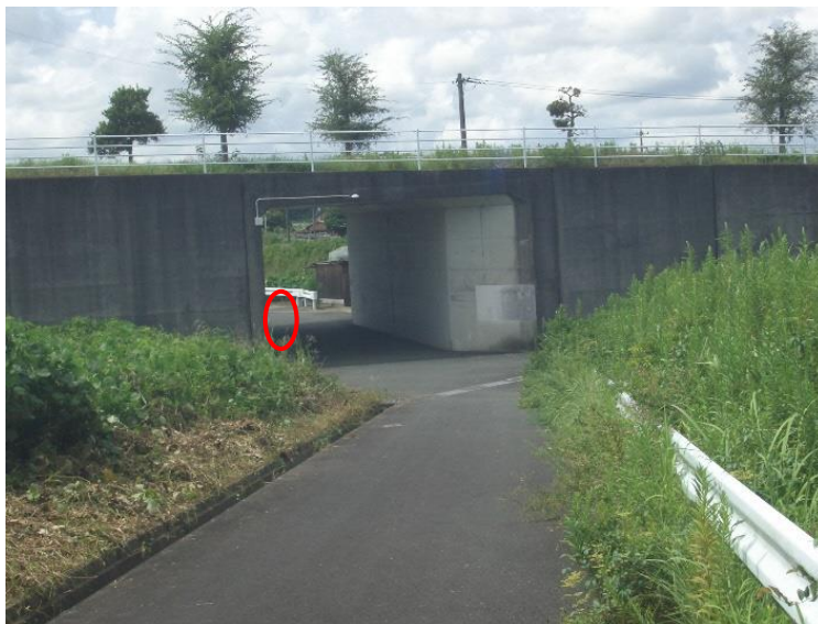
(橋区 パトロール時、糞を確認)
