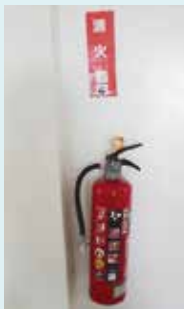
しょうかき 消火器
