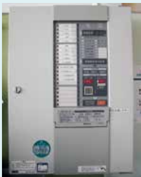
じどうかさいほうち 自動火災報知せつび (受信機)
