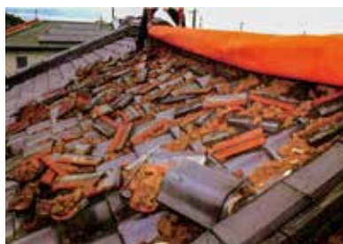
屋根がわらが壊れた家 （掛川市役所危機管理課提供）
