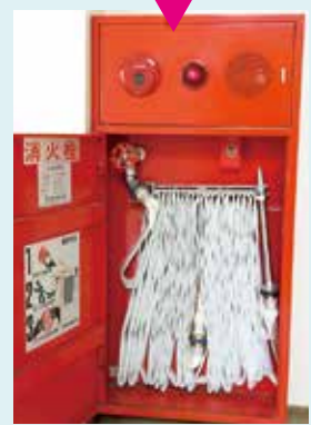
しょうかせん 消火栓 (発信機)
