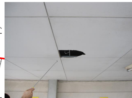
軒天井ケイカル板の破損
