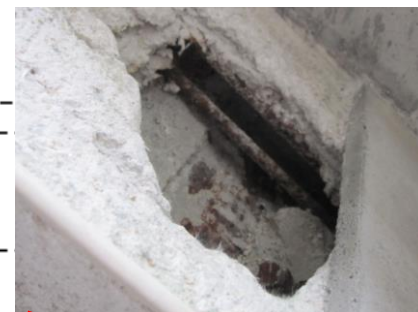
鉄骨ブレース耐火被覆の破損 (該当多数)
