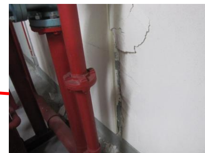
ALC壁の破損
