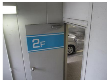
片開き型常閉防火戸 ドアクローザー脱落 ストッパー固定(各階)
