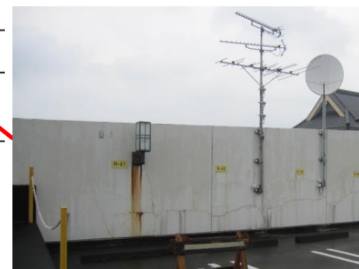
RC外壁クラック・浮き
