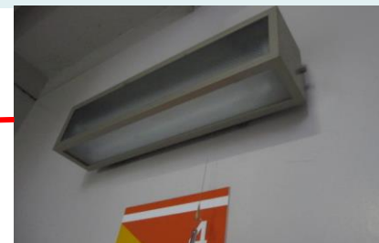
非常用照明の不点灯(該当多数)
