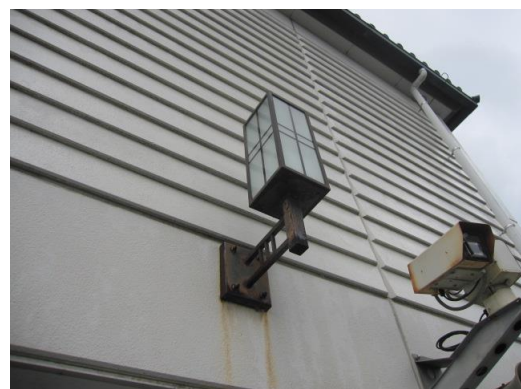
屋外照明支持部錆
