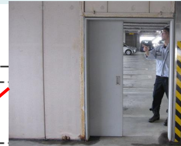
片引き型常閉防火設備 の動作不良
