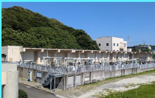
掛川浄化センター
