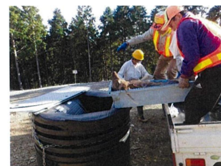
簡易的な埋設設備 （コルゲート管）
