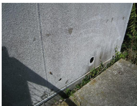
旧大淵幼稚園 外壁に穴 ⇒園舎：外壁D評価
