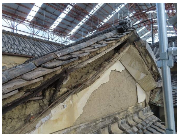
山崎家住宅 外壁はくり ⇒物置（奥蔵）：外壁D評価
