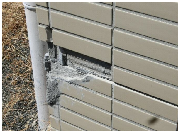
大須賀図書館 タイル剥がれ ⇒図書館：外壁D評価
