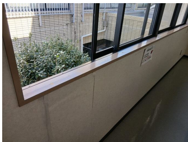
大東児童館 雨水侵入・室内壁紙浮き ⇒児童館：外壁D評価
