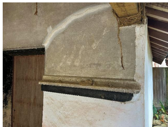
清水邸本宅 壁ひび ⇒土蔵（倉庫）：外壁D評価
