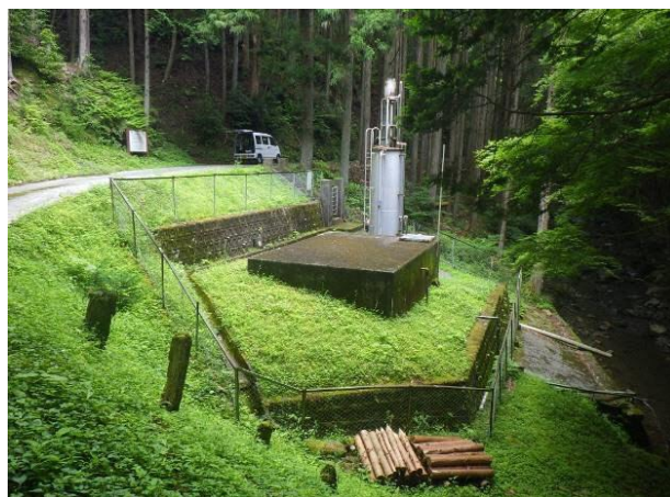
泉簡易水道浄水場
