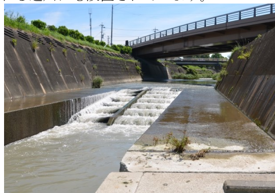
図VI-19 逆川に設置された魚道
