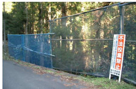
図 ネット・看板設置例
