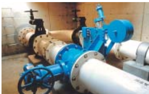
菌ヶ谷配水池緊急遮断弁
