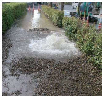
青葉台での漏水
