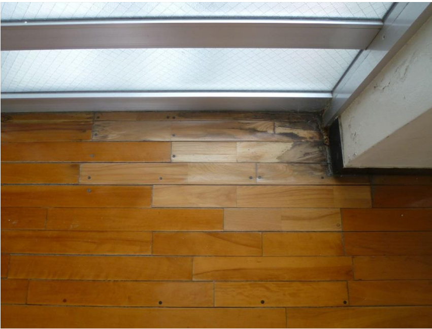
雨漏りによる腐朽
