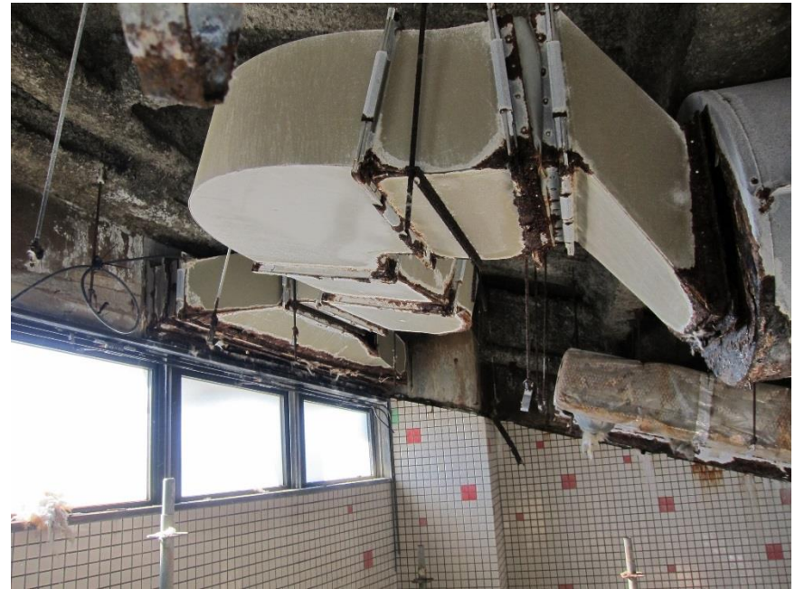
排気ダクトのサビ
