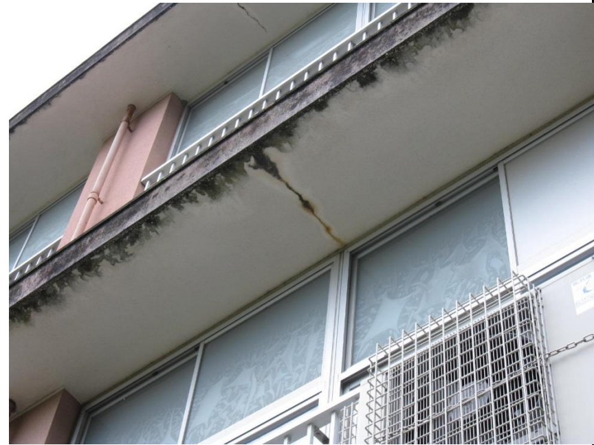
ベランダ下のひび割れ
