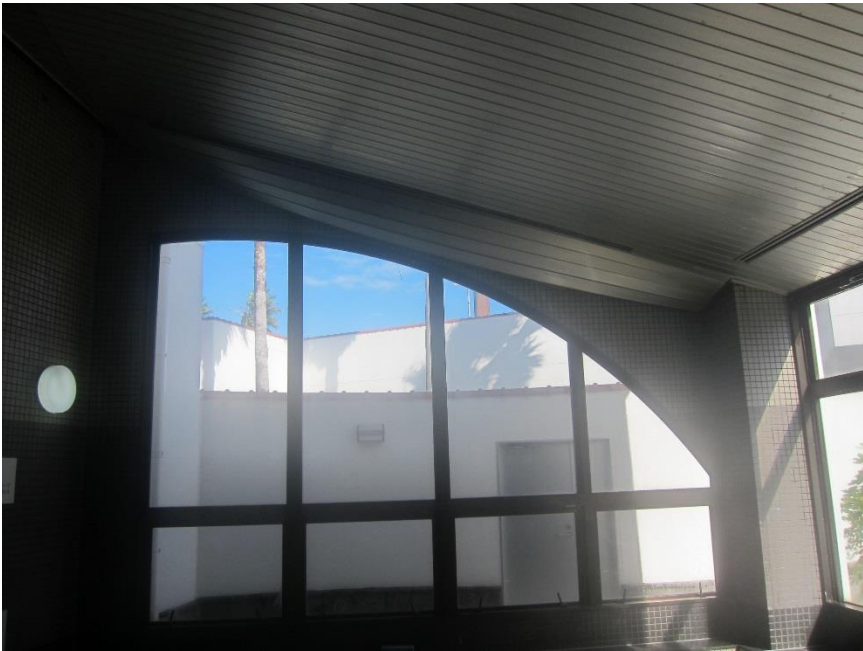
天井のふくれ
