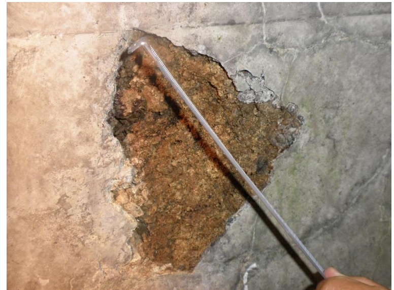
モルタルの剥落(拡大)
