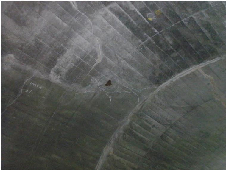
天井のモルタルが剥落
